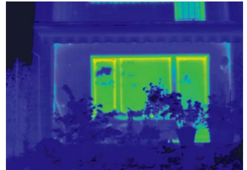
После установки окна Corona CT 70 термографические снимки подтверждают высокую энергетическую пользу сделанной инвестиции. Первоначальные энергопотери практически полностью сошли на нет.
